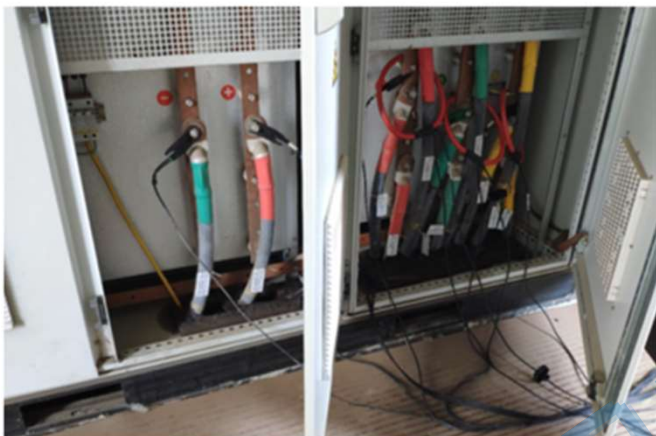
光伏电站500KW逆变器柜
