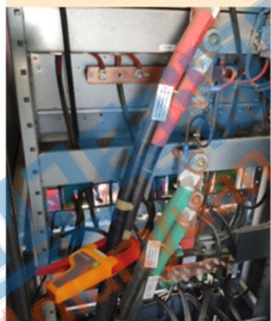
2000A大钳口电钳钳现场测试图 两根粗线缆也能轻松夹持
